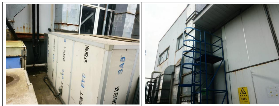
图 4-2 项目废气处理设施及排放口
